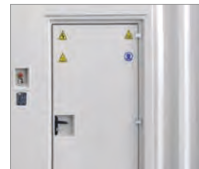
▲ Porte di accesso laterali al gruppo elettrogeno
