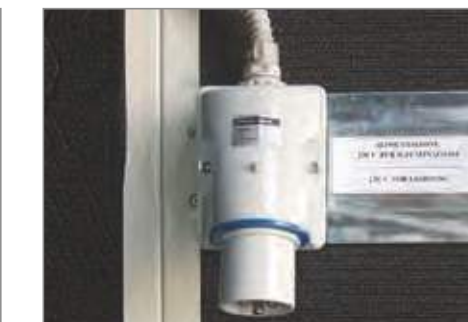
▲ Punto di alimentazione interna 230V
