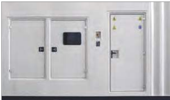
▲ Vano quadro elettrico con finestra in LEXAN
