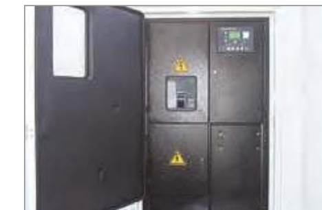
▲ Quadro di distribuzione montato a bordo del gruppo elettrogeno lato lungo
