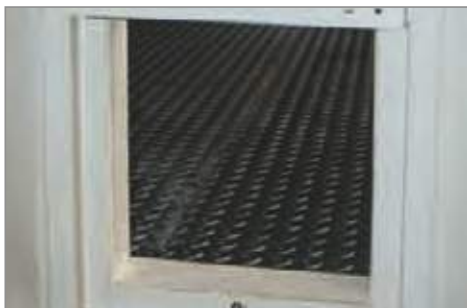
▲ Apertura per ingresso cavi di potenza
