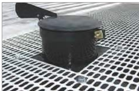
▲ Marmitta residenziale ad alto abbattimento acustico interna al container e griglia espulsione aria calda
